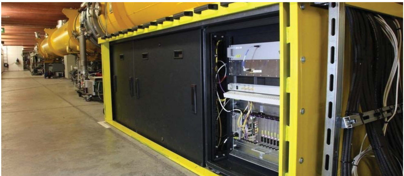
Abb.: Vollfunktionsfähiges Timing/LLRF Steuersystem auf Basis von MTCA.4 installiert in FLASH (Free electron Laser in Hamburg). Erzeugung von ultra-kurzen Laserblitzen (4,1 nm).
